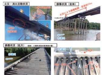
流れ橋が火災損傷
