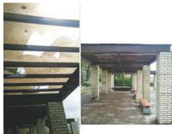
市内公園で花見をされていた方より、屋根付き休憩所の樹脂製の屋根が割れて危険だと連絡をいただきました。早速、現場を確認し、市役所の担当課に説明して、対応を依頼をしました。落下の恐れがあるものを確認し、取り除いて改修の準備をするということです。このような連絡を下されるのは本当にありがたく、今後もお気づきがございましたら、ご一報をお願いします。
