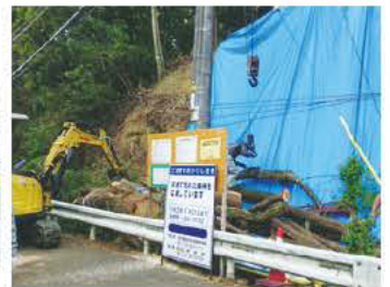
昨年の台風で土砂崩れした橋本東山本地内の補強改修工事。京都府の平成27年度災害に強い森づくり事業予算が活用され、危険木の除去と斜面の補強がされます。今年の夏には間に合いますが、工事開始までに要した時間が長く、皆さまにはご心配をおかけしました。今回の教訓を生かして、早期着工できるように働きかけます。今年の夏は大雨が降らない事を願います。
